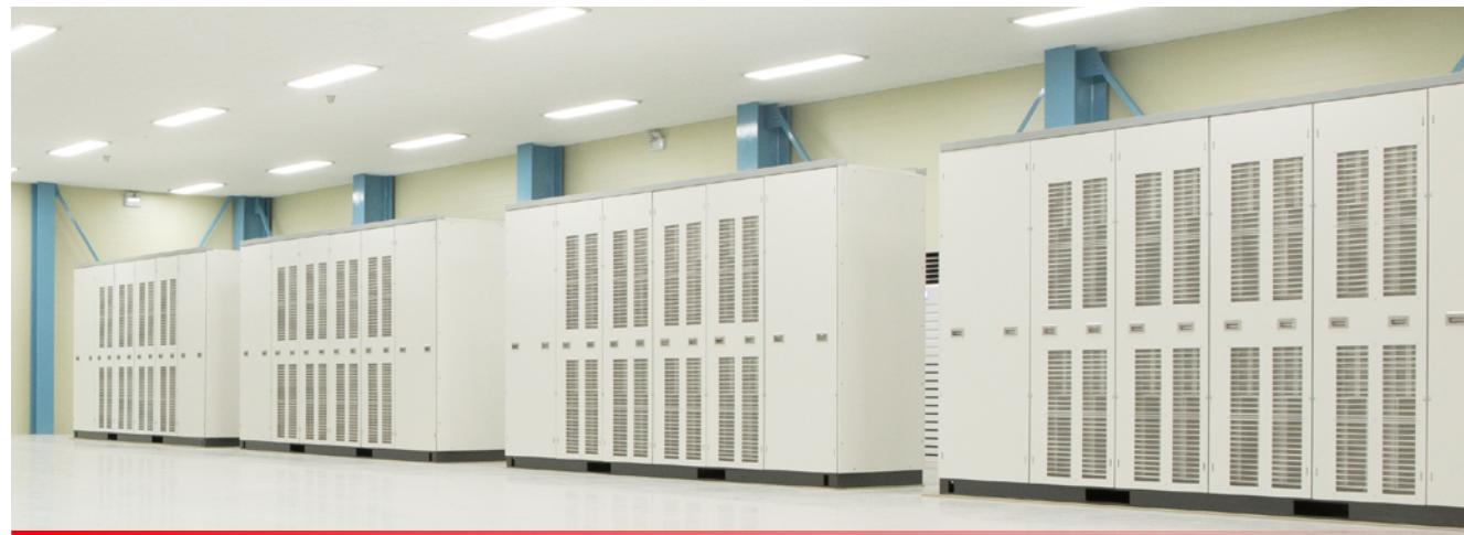
ESS (Energy Storage System, 에너지 저장 장치)
