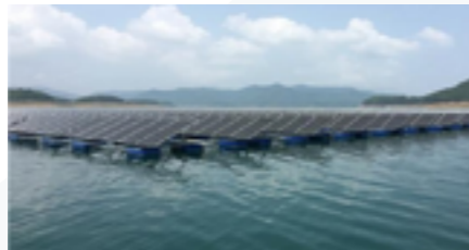
한국수자원공사 수상태양광 11MW
