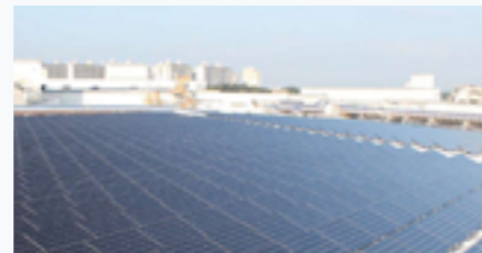
오창 LG화학 / 구미 LG전자 공장 6MW
