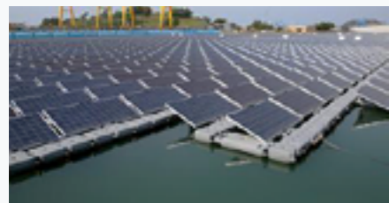
세종시 서부발전 수상태양광 5.9MW
