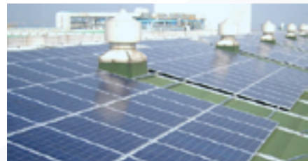
OCI 군산, 광양, 전주, 벽슬론 지붕형태양광 4.2MW
